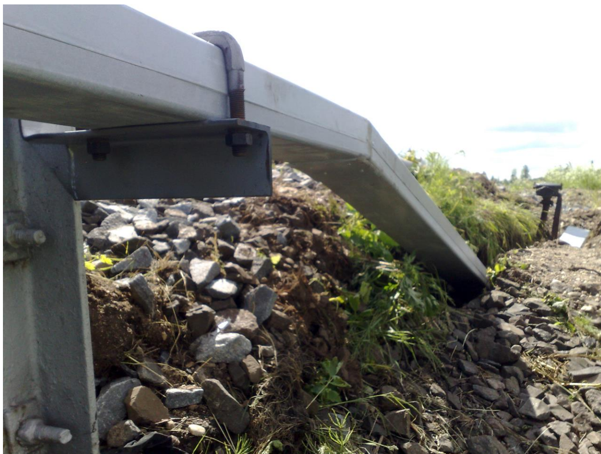
Кабельный «мостик» вдоль ж/д путей (Латвия)
