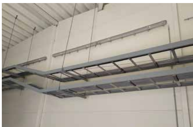
Balticovo, kabelplauktu sistēma
