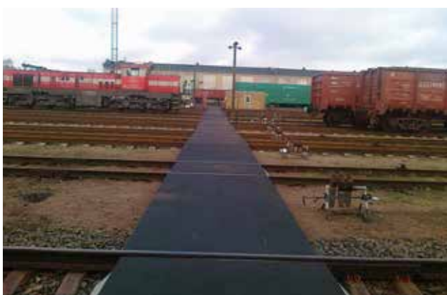
Sliežu gājēju pāreja ar neslīdošu pārklājumu
