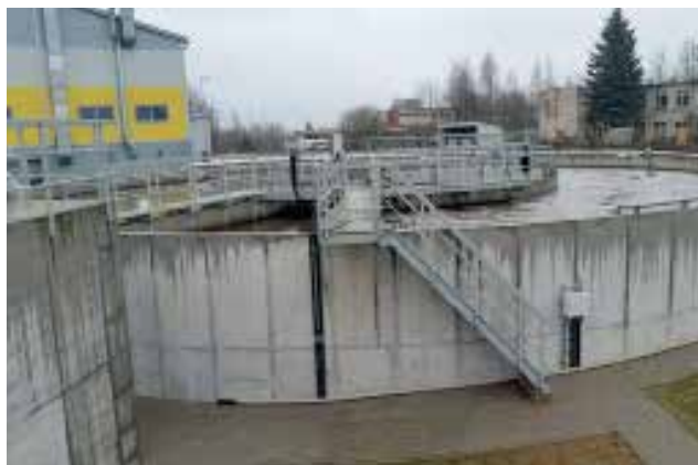
Notekūdeņu attīrīšanas iekārtas kāpnes un platforma
