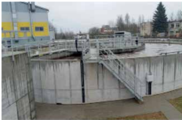
Notekūdeņu attīrīšanas iekārtas kāpnes un platforma
