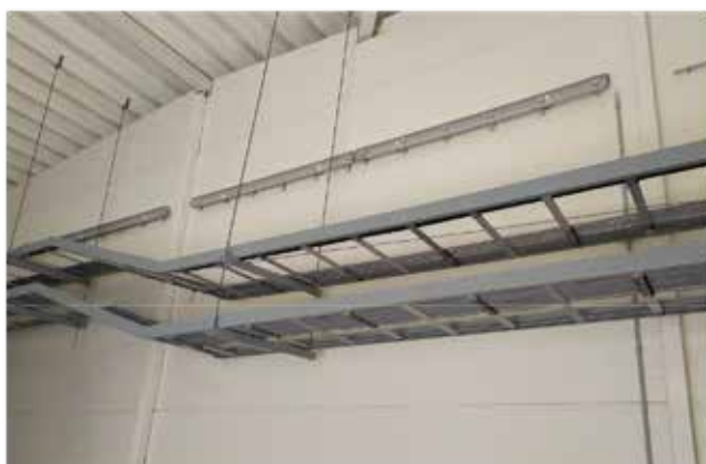
Balticovo, kabelplauktu sistēma
